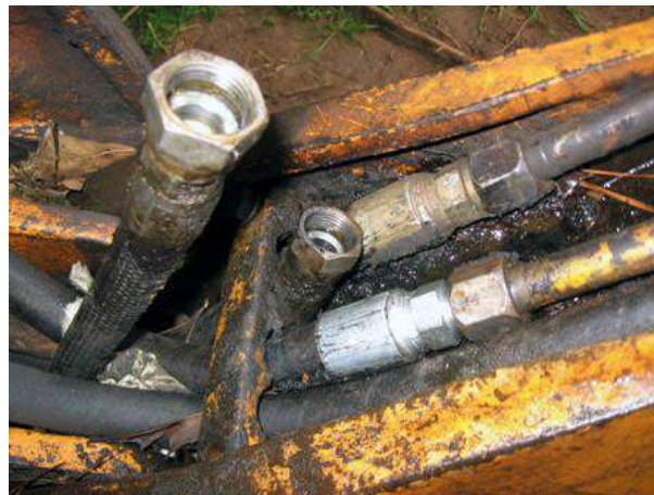
Figura 3.16. Líneas, empalmes, mangueras y tuberías.
