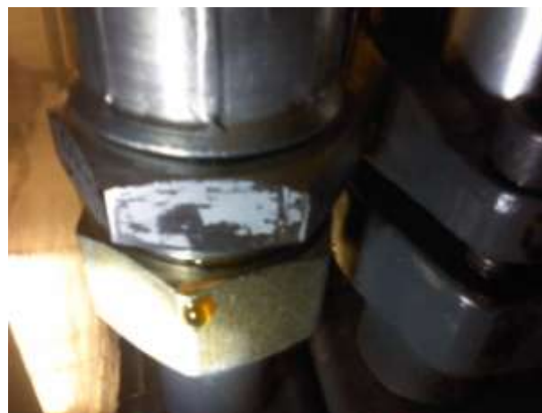
Figura 4.3. Empalme hidráulico dañado.
